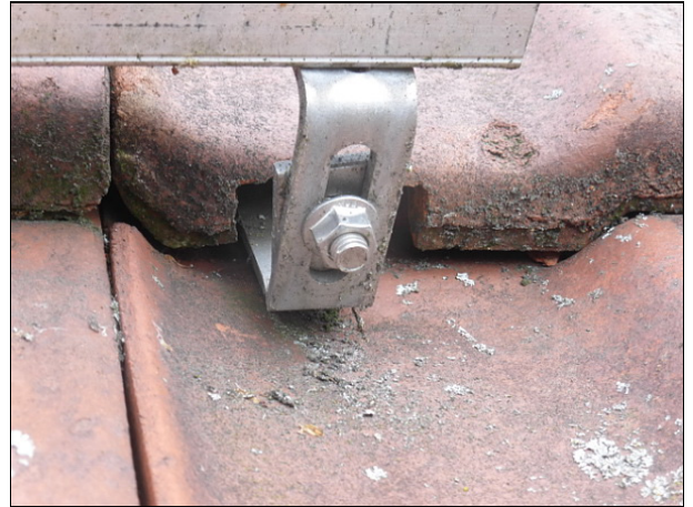
Abbildung 6 Bei diesem Dachziegel wurde die Fußrippe nur wenig größer als erforderlich ausgefräst.
