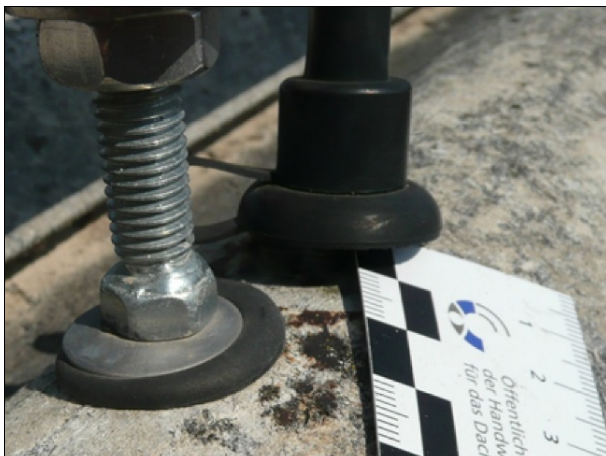
Abbildung 7 Durch die in unmittelbarer Nähe erfolgte neue Befestigung ist die alte Befestigung der Wellplatten entlastet und undicht geworden.
