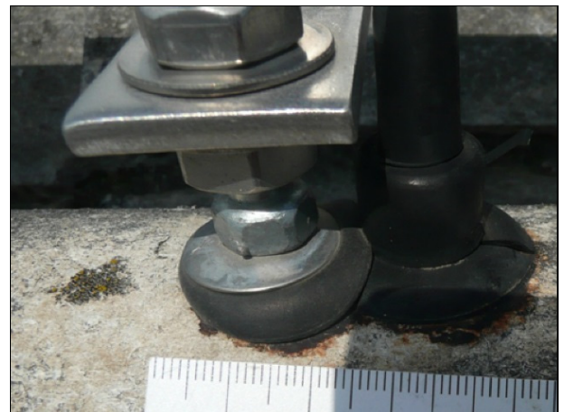
Abbildung 8 Aufeinander sitzende Dichtungen/eng beieinander montierte Schrauben führten zu Schadstellen mit Bruchgefahr
