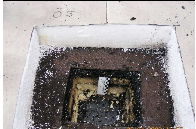
Bild 3: Öffnungsstelle in der Fläche mit stark durchfeuchteten PUR-Dämmstoffen unter der verbliebenen, alten Abdichtung aus Bitumendachbahnen
