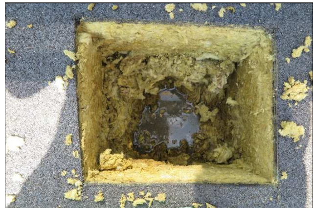
Bild 5: Stark durchfeuchtete Mineralwolledämmung und Wasser auf der Dampfsperbahn
