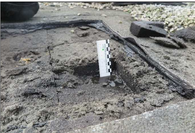
Bild 4: Ca. 5 cm dicke Dämmschicht aus Schaumglas. Wasser sickert nach Entfernen des Dämmstoffs nach.
